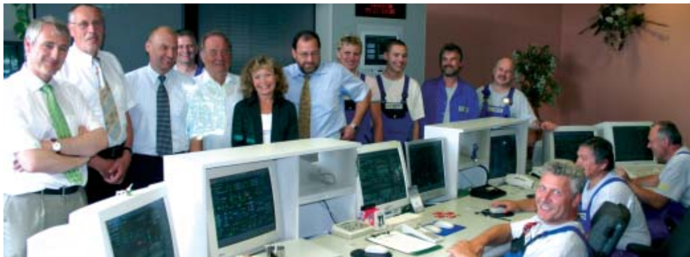
Die Messwarte ist das Herz der Anlage. Hier wird gesteuert und überwacht, damit 365 Tage im Jahr und 24 Stunden am Tag alles funktioniert. In der Warte hier die Geschäftsführer der KWG (v.l.) Dr. Henning Müller-Tengelmann und Bernd Petzold. (Foto: SWG)
